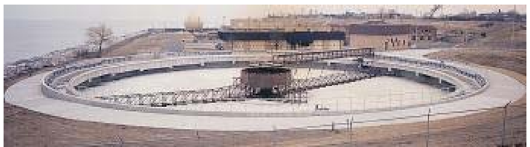
ถังตกตะกอนแบบวางสะพานครึ่งเดียวพร้อมชุดขับเคลื่อนวางบริเวณกลางถัง Half Bridge Clarifier
